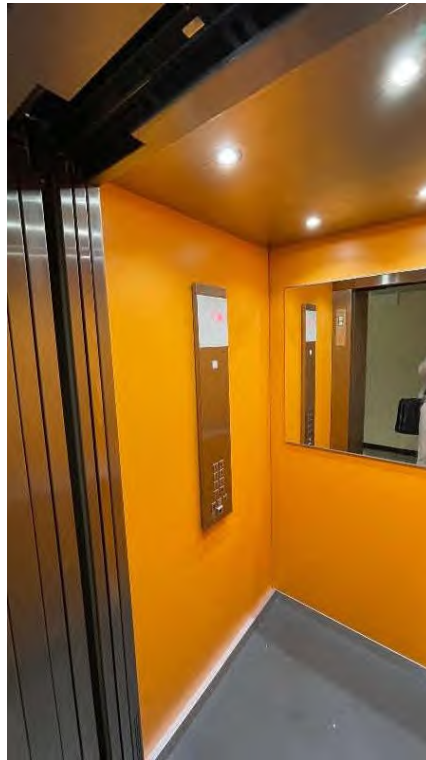
17 Angermaierstr. 53, EG, Aufzug Baujahr 2018
