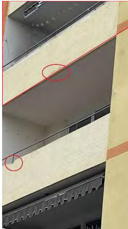
31 Angermaierstr. 53, Südfassade, Beispiel Nässe am Balkon der Bewertungswohnung, Beispiel abgebrochene Brüstung (Wohnung unter Bewertungswohnung)
