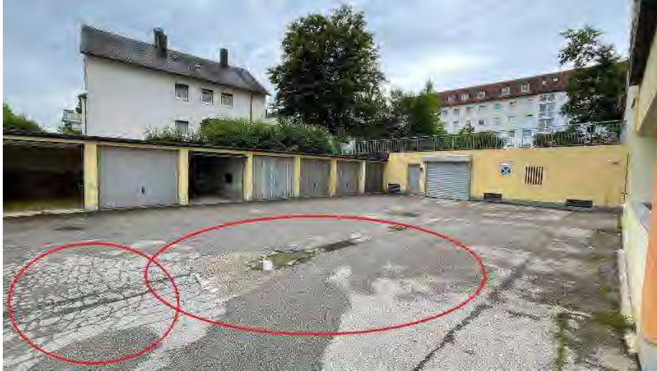
33 Angermaierstr. 53, Hof, beschädigte Teerdecke
