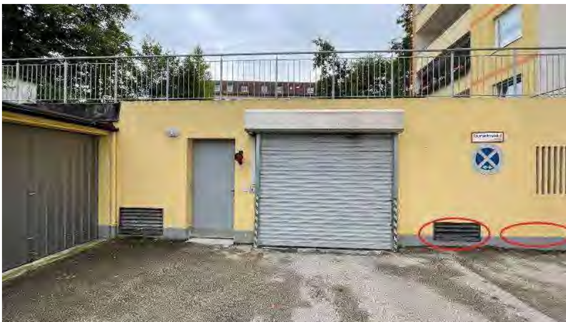
36 Garage, Blick auf die Ostfassade mit Zugangstor, verbogenes Lüftungsgitter und Nässe Spuren im unteren Drittel der Wand
