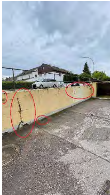
34 Angermaierstr. 53, Risse, Vermoosung, Putzabplatzungen in der Böschungsmauer zur Angermaierstraße
