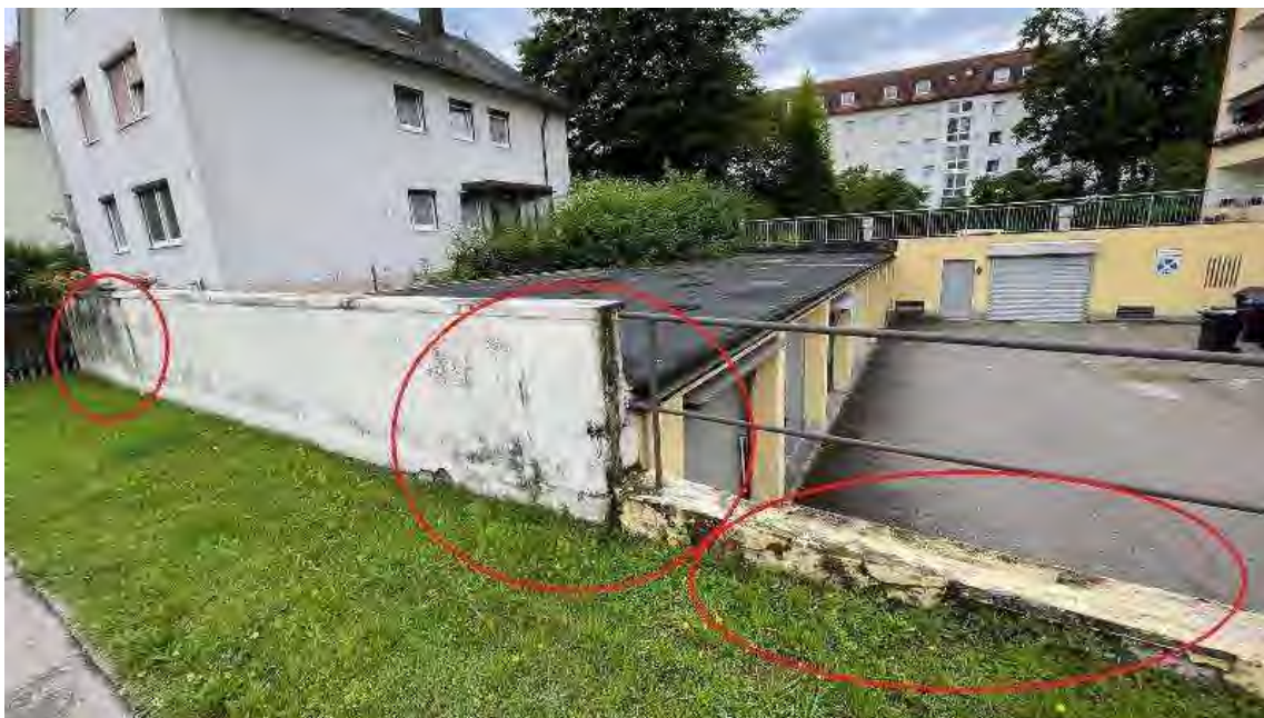
35 Angermaierstr. 53, Vermoosung und Verfärbungen an Böschungsmauer zur Angermaierstr.
