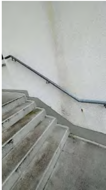
13 Angermaierstr. 53, vermooste Eingangstreppe, Verfärbungen an der Fassade
