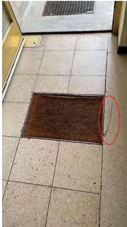
15 Angermaierstr. 53, Beispiel gesprungene Fliesen im Hauseingangsbereich
