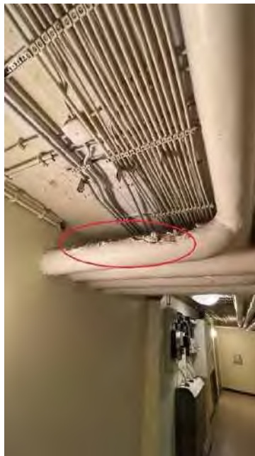
24 Angermaierstr. 53, KG, Beispiel beschädigte Isolierung Rohre
