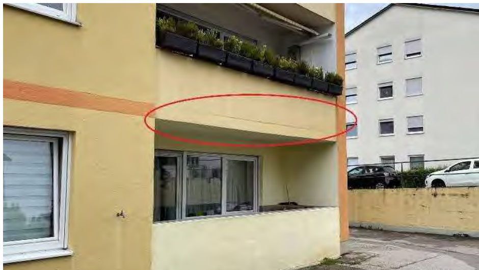
32 Angermaierstr. 53, Südfassade, Beispiel Risse an Balkonen
