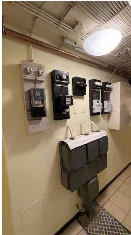
25 Angermaierstr. 53, KG, Hausflur, Elektrik
