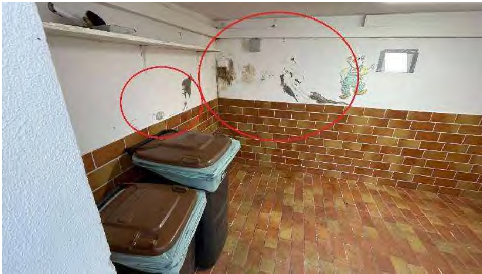
29 Angermaierstr. 53, Mülltonnenraum, Wasserschaden an Süd- und Westwand
