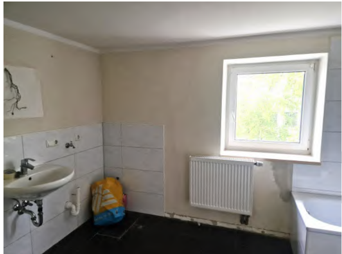
Wohnung OG Bestand (Bad mit verschiedenen Abnutzungsspuren)
