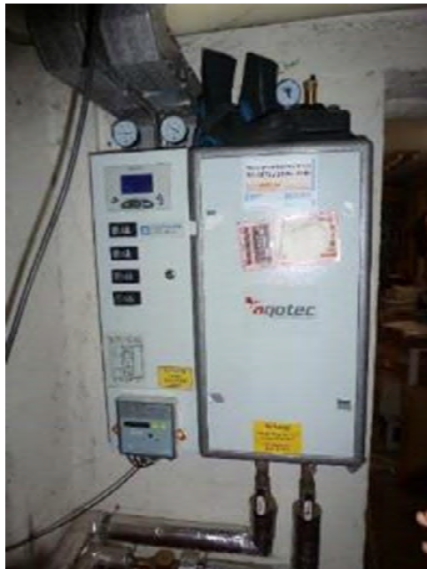
Heizung im KG
