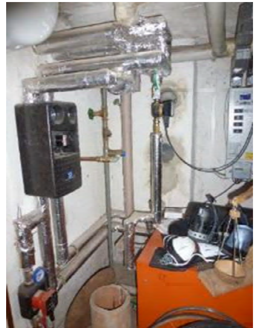
Heizung im KG
