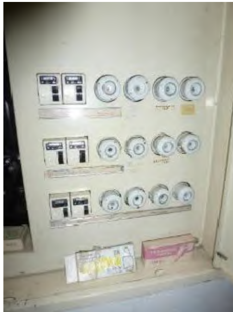
Elektrohauptabsicherung im KG
