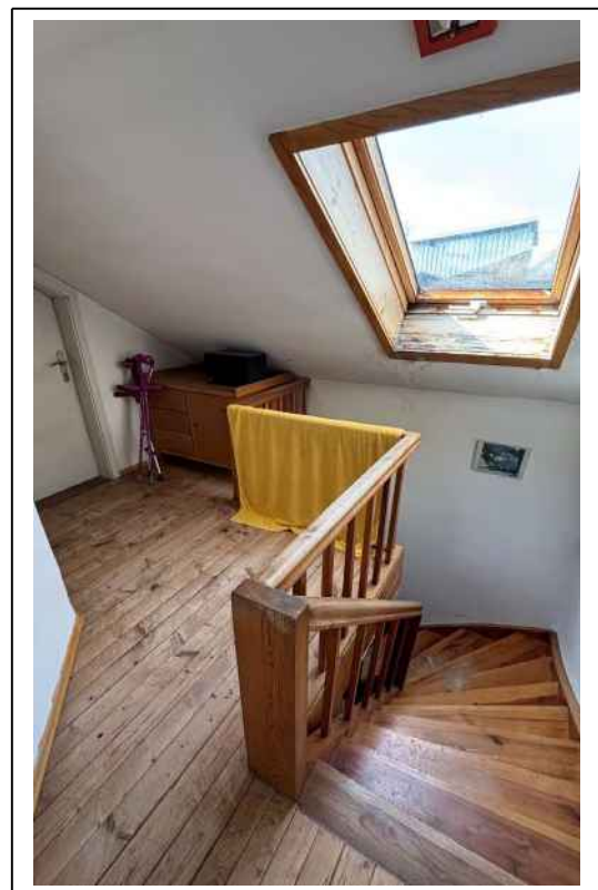
Foto 27: DG-Flur, verwittertes Holzfenster
