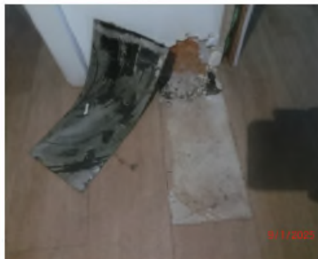
... mit Beispiel der Auswirkungen des danach erfolgten Wasserschadens
