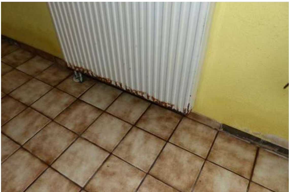
Abbildung 8: Verrosteter Heizkörper im Windfang, schadhafte Abschlussleiste
