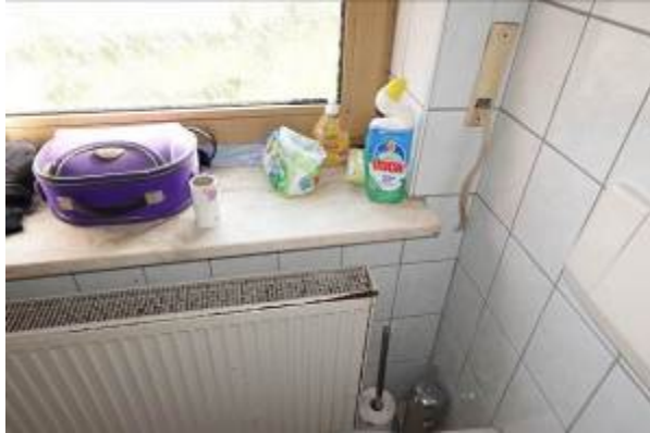
Erneuerungsbedürftiger Rollladengurt im Badezimmer (EG)
