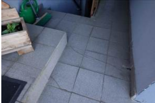
Schadhafter Bodenbelag vor dem Hauseingang
