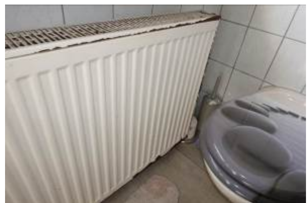
Erneuerungsbedürftiger Heizkörper im Badezimmer (EG)
