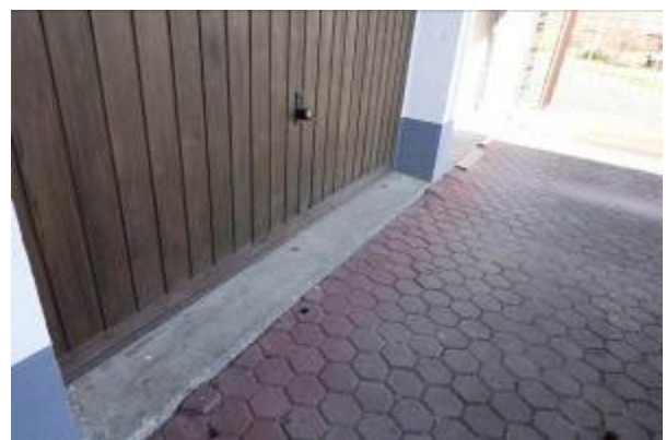
Höhenunterschied zwischen Doppelgarage und Grundstückszufahrt
