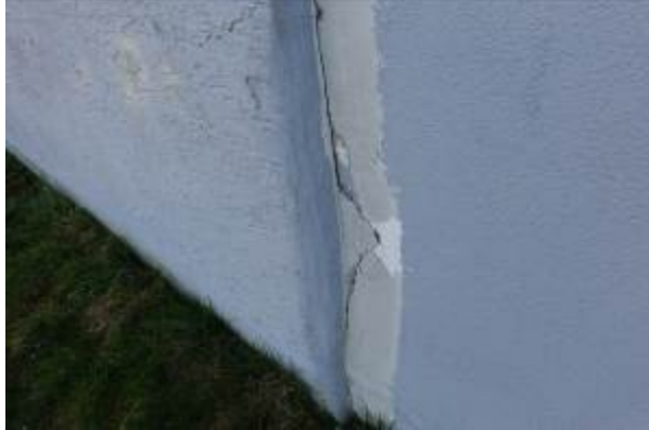
Instandsetzungsbedürftige Nordwestfassade der Doppelgarage
