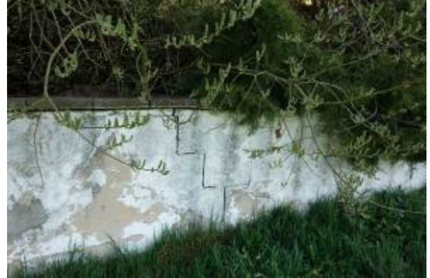
Instandsetzungsbedürftige südwestliche Stützmauer
