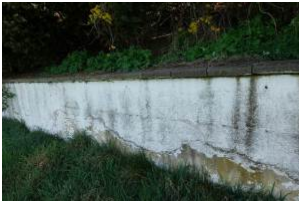
Instandsetzungsbedürftige südwestliche Stützmauer
