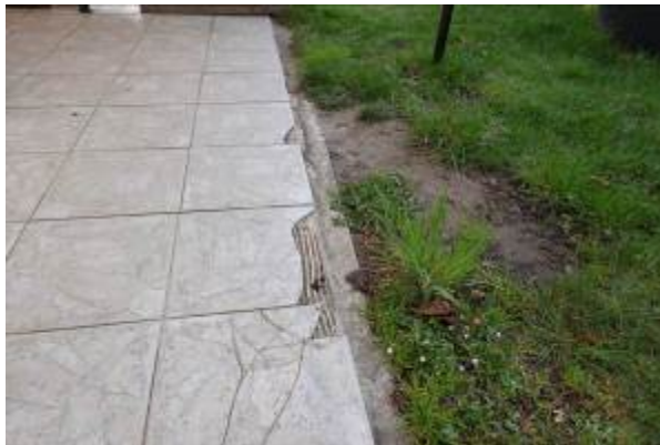
Erneuerungsbedürftiger Bodenbelag der Südostterrasse
