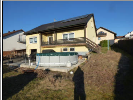
Fotoaufnahme der Bodenplatte beim Ortstermin
