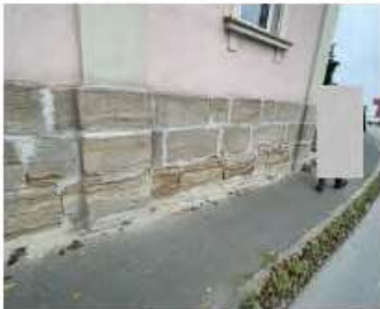
Beispiel baulicher Auffälligkeiten Zustand Gebäudefassade O
