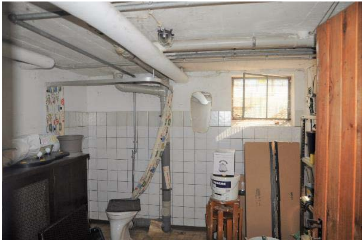
Abbildung 10 KG - Kellerraum gemäß Plan „Geräte“
