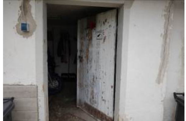
Instandsetzungsbedürftige Zugangstür des Nebengebäudes
