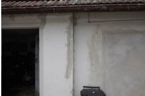
Instandsetzungsbedürftige Fassade des Nebengebäudes
