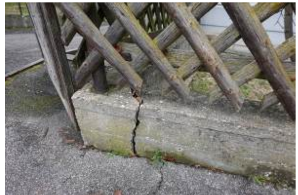
Schadhafte Stützmauer zur Johann-Sebastian-Straße
