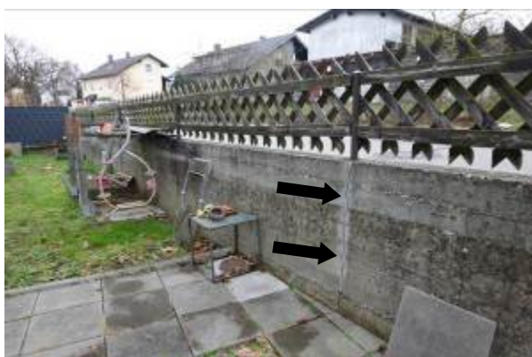
Schadhafte Stützmauer zur Johann-Sebastian-Straße
