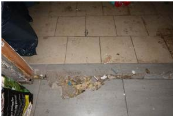
Instandsetzungsbedürftiger Bodenbelag des Nebengebäudes
