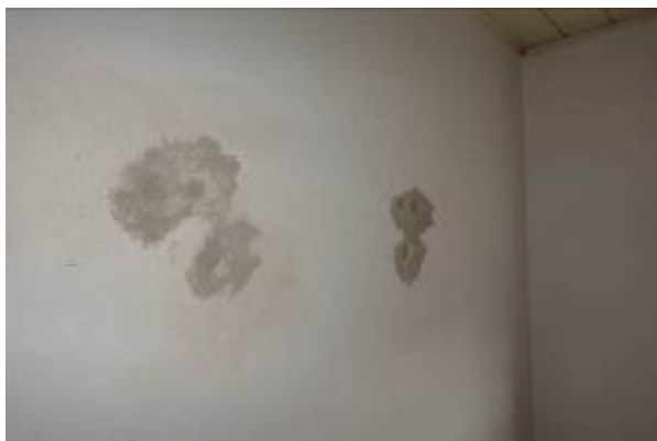
Exemplarische überarbeitungsbedürftige Wandbekleidung im DG
