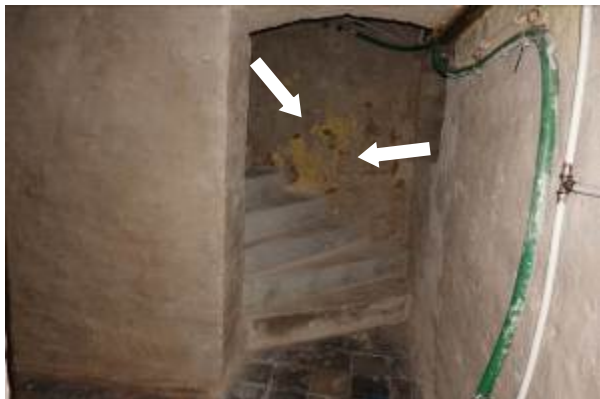
Feuchteschäden an den Kelleraußenwänden
