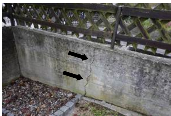
Schadhafte Stützmauer zur Grundstückszufahrt
