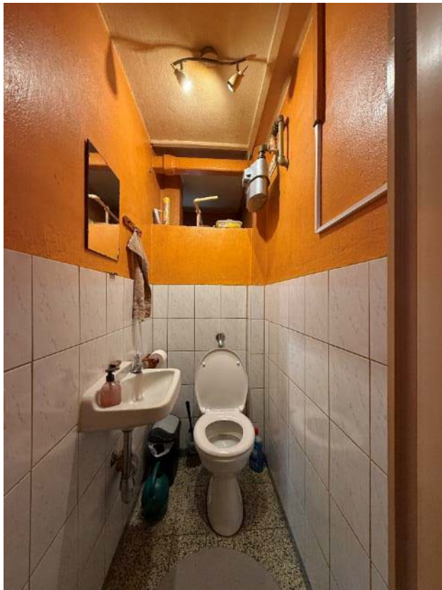
Abbildung 14 1.OG / WE Nr.3 – WC / Wanddurchbruch zu Abstellkammer/Speise
