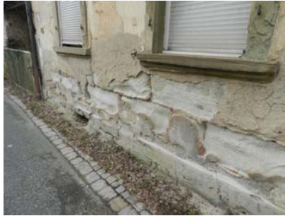
Schäden an Fassade
