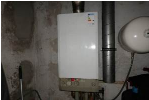
Heizungsraum des Restaurants im EG
