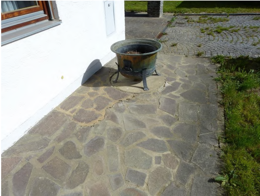
Gebäude 1: Einfamilienhaus mit Einliegerwohnung, Hausumgang mit Absenkungen
