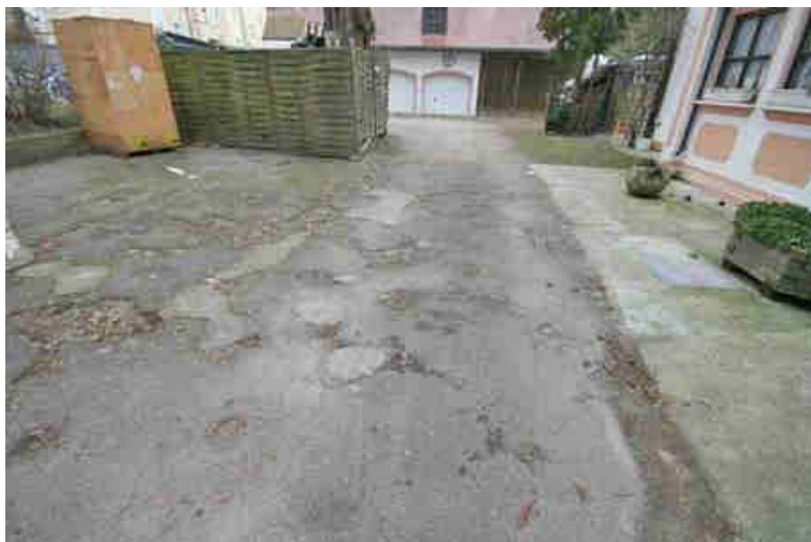
Blick auf aufgebrochene Hofraumbefestigung, im Bildhintergrund Gebäude 4
