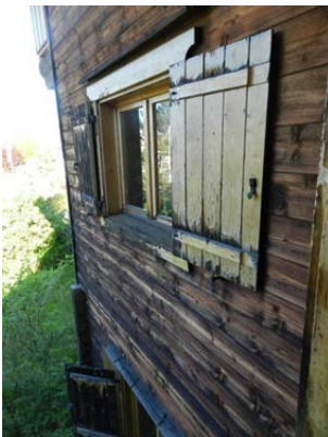
Verwitterte Fenster und Fensterläden
