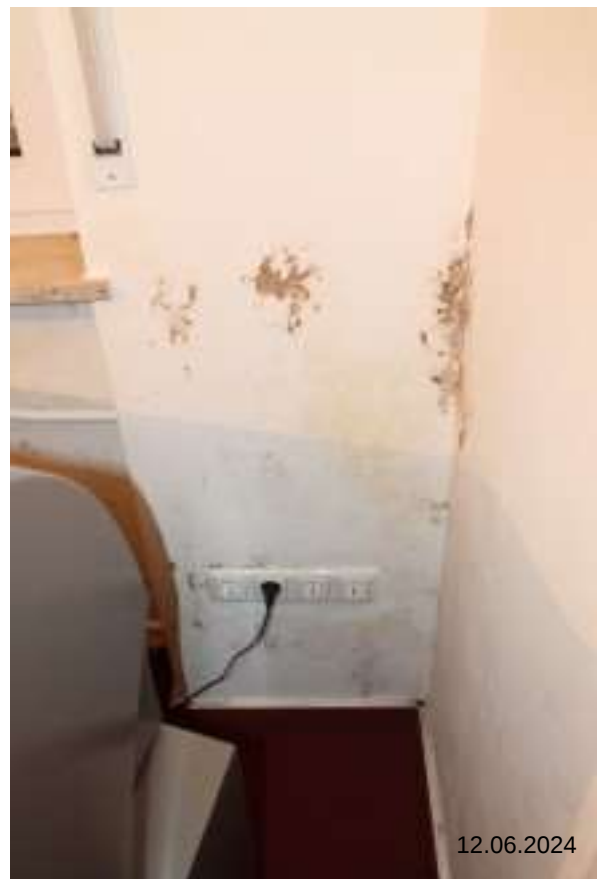
Bild 23: Fl.Nr. 98 DG: Schimmel- / Schwammecke im Gästezimmer 1
