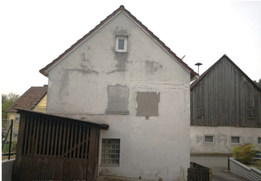
Fehlende Abschlussarbeiten an der Fassade nach Vermauerung der ehemaligen Fensteröffnungen
