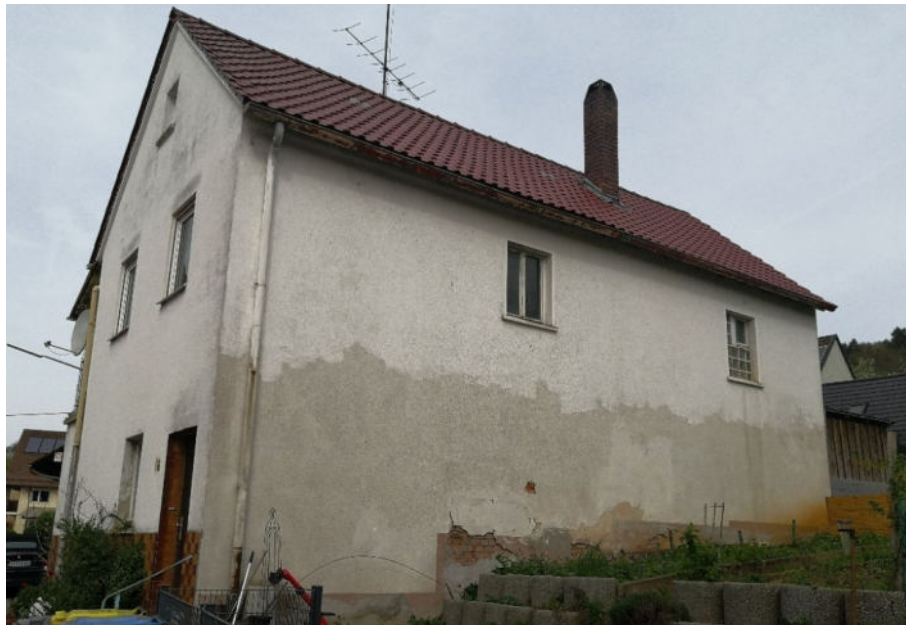
Traufseite mit massiven Putzschäden -Teilweise aufsteigende Feuchtigkeit-
