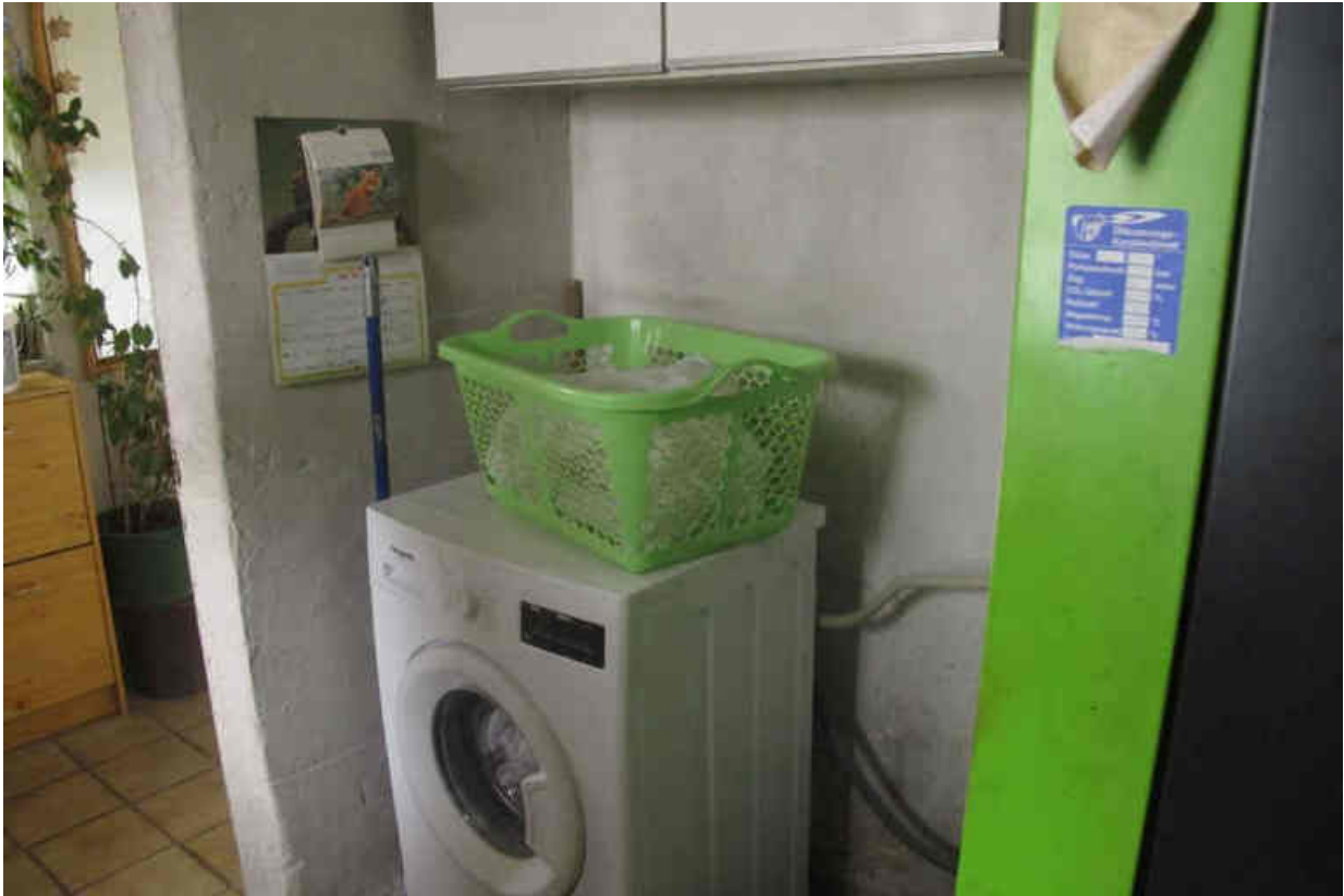
Foto 5 – Teilfläche A – ZFH – Wohnung im EG/OG - Heizraum
