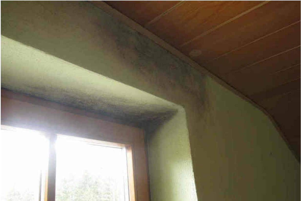
Foto 17 – Teilfläche A – ZFH – Wohnung im OG/OG – Nordseite DG - Schimmelbildung
