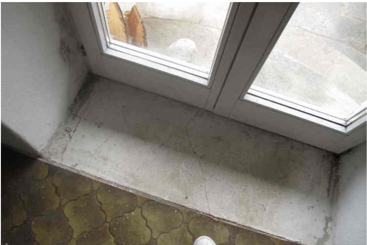
Foto 8 – Teilfläche A – ZFH – Wohnung im EG/OG – Fenstertür mit Schimmel in der Laibung
