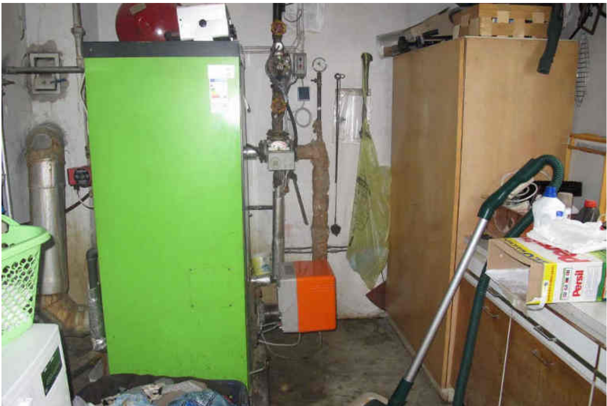
Foto 6 – Teilfläche A – ZFH – Wohnung im EG/OG - Heizraum
