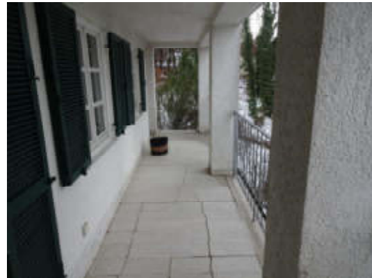
Fliesenschäden Balkon Westseite
