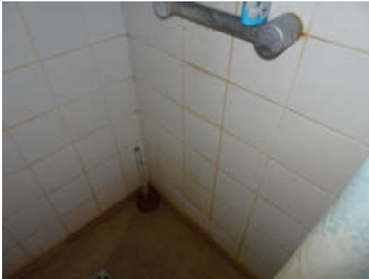
abgenutzte Dusche OG mit Verfärbungen
