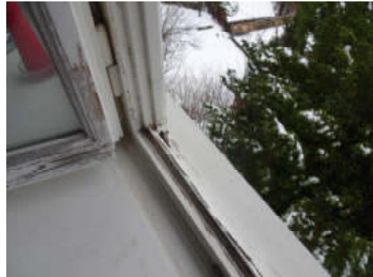
abgewittertes Fenster DG
