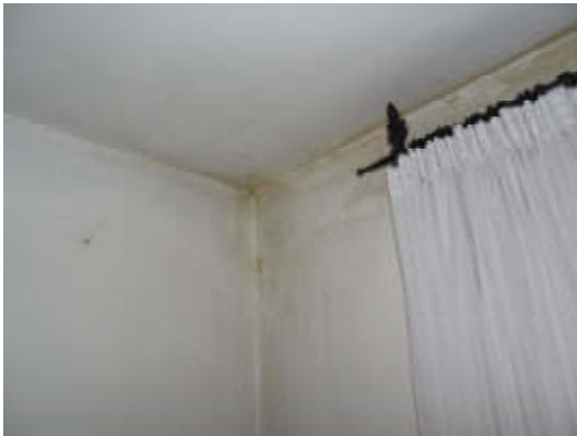
Verfärbungen im Wandbereich
