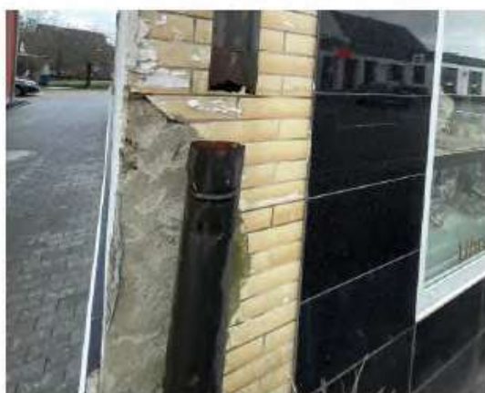
Beispiel baulicher Auffälligkeiten
