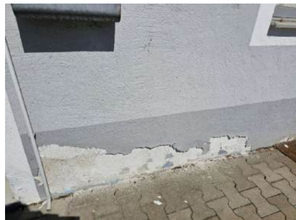
Werkstattgebäude westlicher Teil/ Putzschäden
