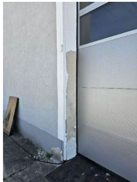
Schäden an Toreinfahrt
