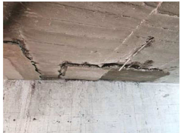
Keller/ Lagerraum 1/ Schäden an Kellerdecke
