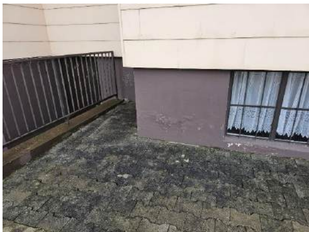
Putzabplatzungen Sockel Gebäudenordseite
