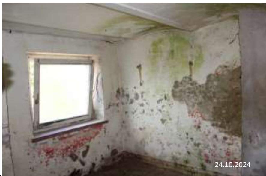
Bild 23: Fl.Nr. 908 Wohnhaus KG – Keller – Wasser- eindringstellen vom Dach Anbau Norden
