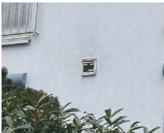
Ostfassade - Lamellenbruch am Lüftungsauslass
