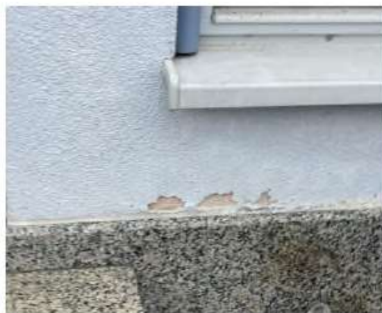
Ostfassade - Putzabplatzungen im Sockelanschlussbereich am Hauseingang
