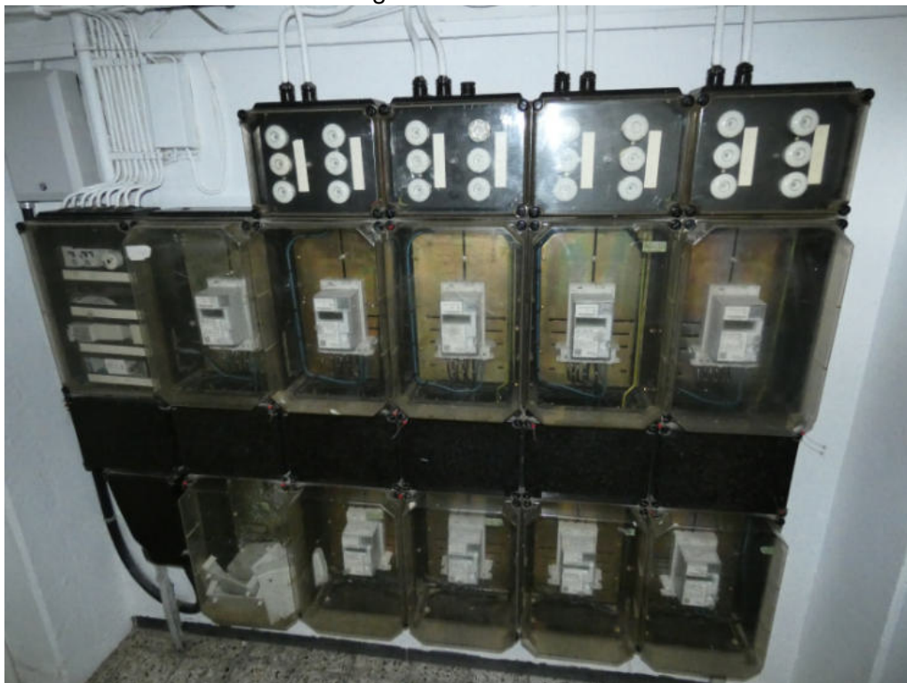
Bild 7: Elektrische Hautverteilung im Keller mit den Stromzählern
