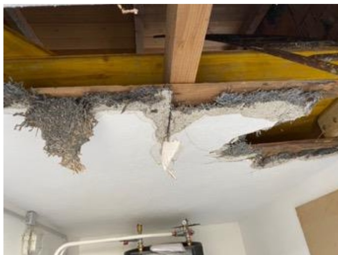
Schadhafte Decke im Haustechnikraum
