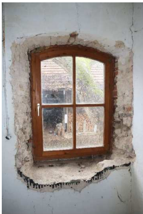
Wohnhaus – EG – nicht eingeputztes Fenster Zimmer 3
