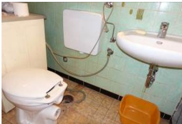
Schadhafter Abfluss im Badezimmer der Wohnung Nr. 40
