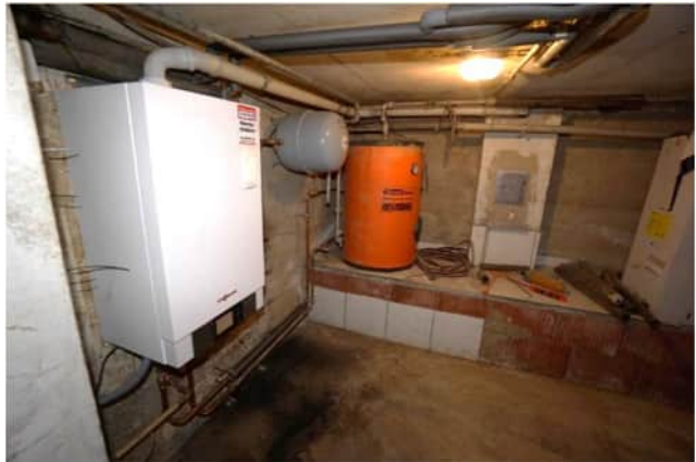
Wohnhaus Kellergeschoss Heizraum
