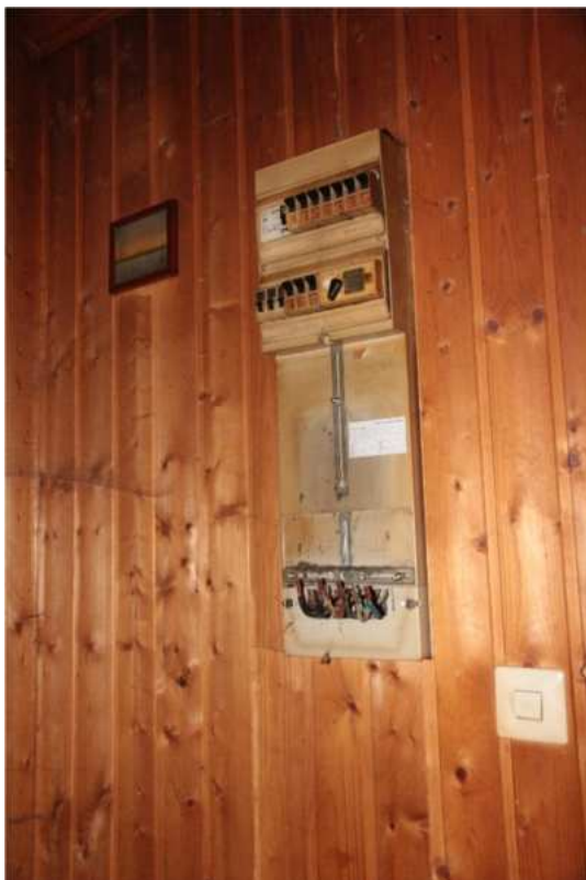
Sicherungskasten im Treppenhaus
