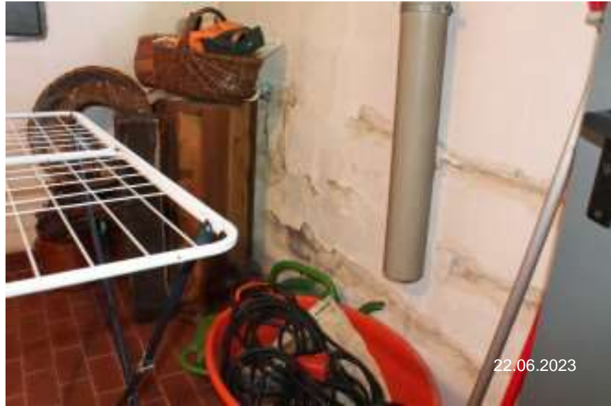
Bild 20: KG: Putzabplatzungen an Aussenwänden hier: Heizraum
