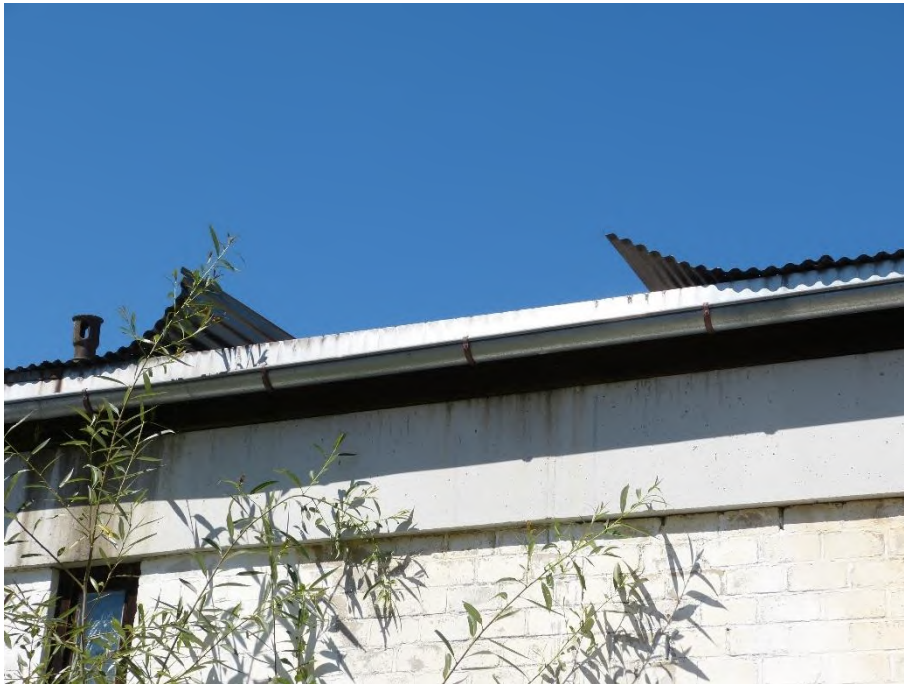
ehemalige Reithalle, Teilansicht schadhaftes Dach
