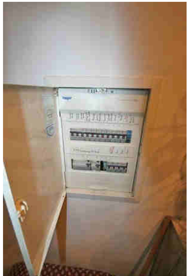
Blick auf Elekt- roverteilerkasten im Flur im DG
