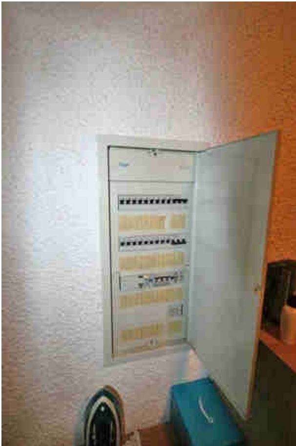
Blick auf Elektro- verteilerkasten im Flur im EG
