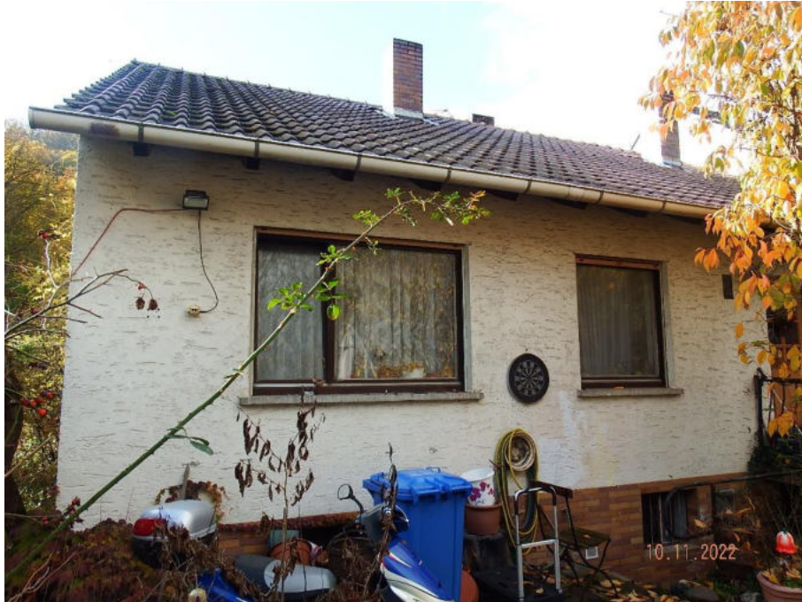
Baujahrestypische Ausstattung, sichtbare Schäden an der Fassade und im Sockelbereich
