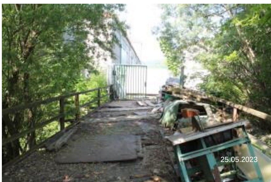
Bild 3: Fl.Nr. 1/76 Ansicht Zufahrt aus Osten – baufäl- lige Brücke
