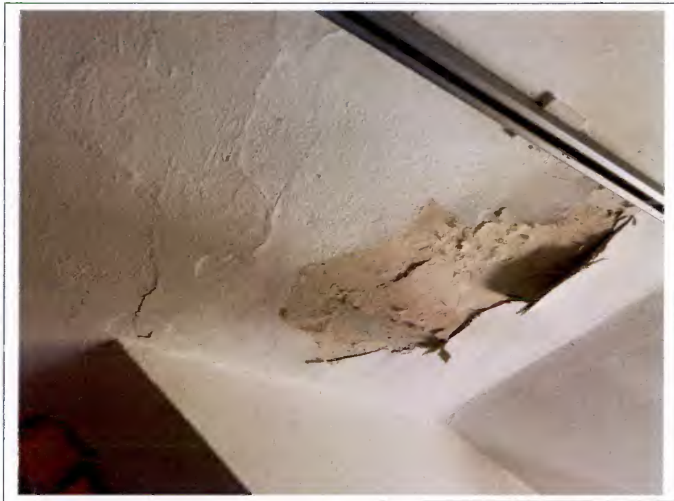
Foto 19: Nässeschaden an einem Dachflächenfenster
