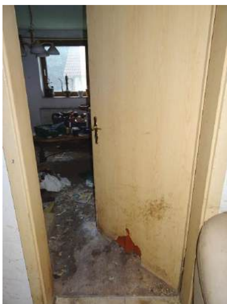
OG/ Zimmertür mit Schäden
