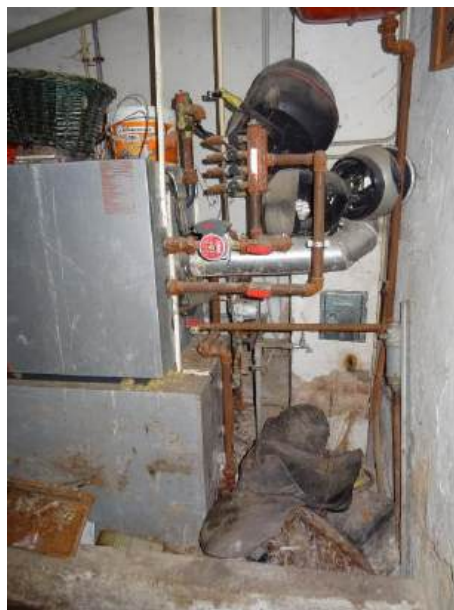
EG/ Heizungsanlage im Wasch- und Haustechnikraum
