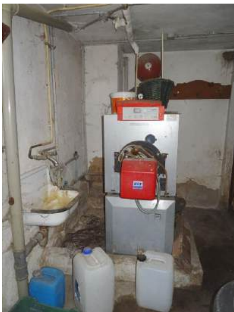
EG/ Heizungsanlage im Wasch- und Haustechnikraum
