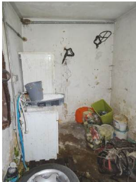
EG/ Wasch- und Haustechnikraum
