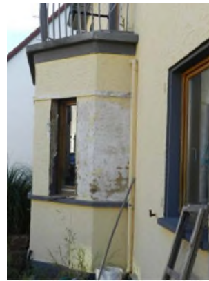
Schaden an Fassade
