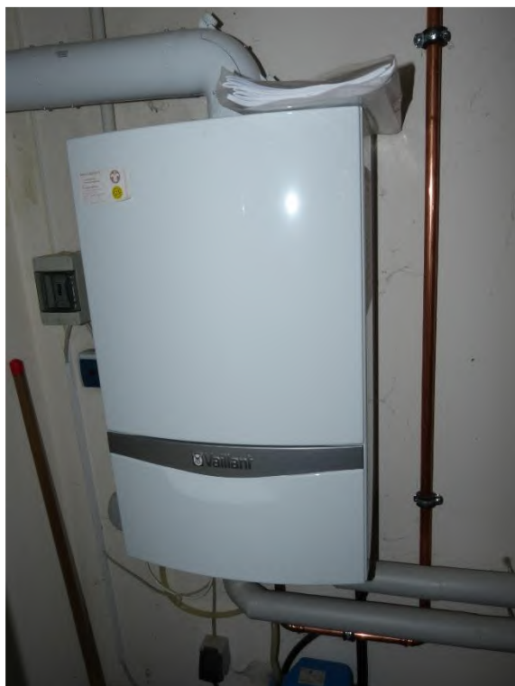
Zweifamilienhaus, Innenaufnahme Gastherme im Erdgeschoss
