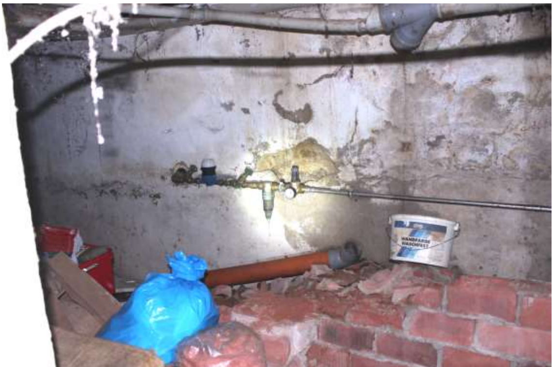
Bild 18: Wasseranschluss im Keller
