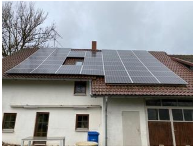
Südansicht PV-Anlage auf dem Wohnhaus bzw. der Garage
