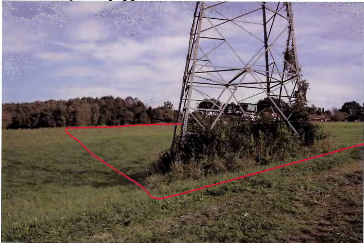
Bild 8: Standort auf dem Anliegerweg mit der Fl.Nr. 864/2, nahe der südwestlichen Grundstücksecke von Flurstück 882, Blickrichtung Norden. Im Bild der Stahlgittermast für die 1100 kV-Freileitung, der sich in der südwestlichen Grundstücksecke von Flurstück 882 befindet. Die oberirdische Freileitung bzw. der zugehörige Schutzstreifenbereich überspannt die Flurstücke 882, 883, 884 und 885 von Norden nach Süden.
