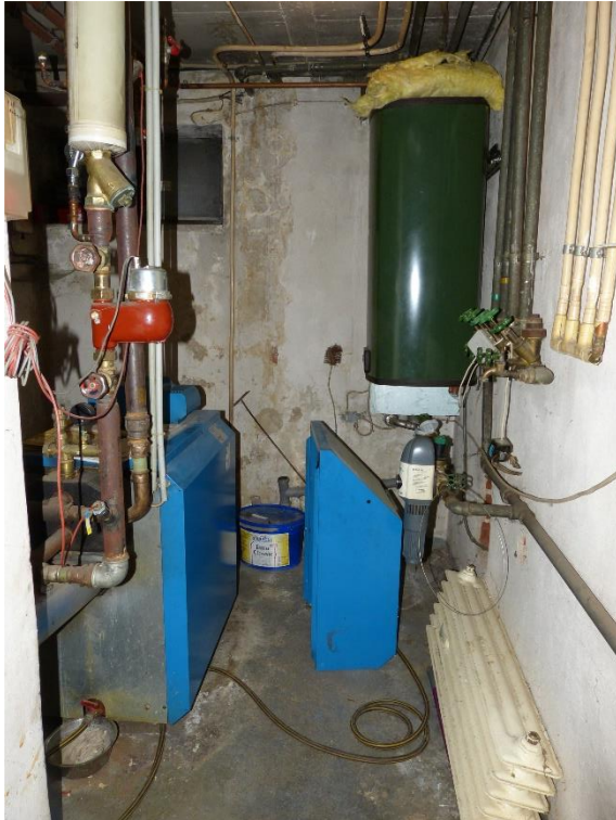
Wohnungseigentum Nr. 1, Innenaufnahme Heizungsraum (Gemeinschaftseigentum) im Untergeschoss des Nachbargebäudes WE Nr. 2)
