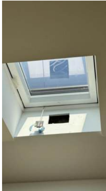
01 Dachflächenfenster im Treppenhauskopf (vermutlich Steuerung lose)
