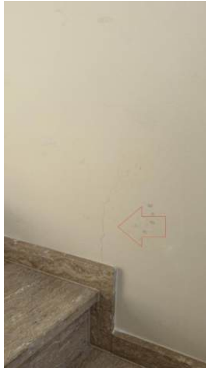
03 diverse Risse im Treppenhaus
