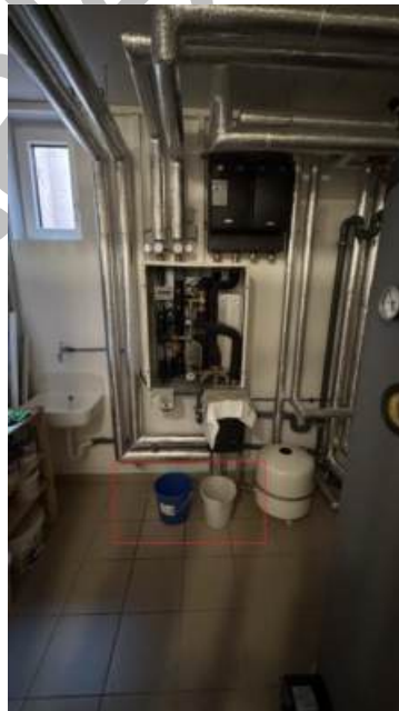
02 Heizungsanlage tropft (am Ortstermin hörbar)
