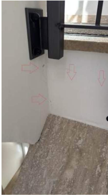
05 diverse Risse im Treppenhaus
