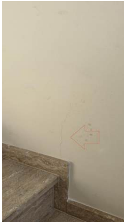
03 diverse Risse im Treppenhaus
