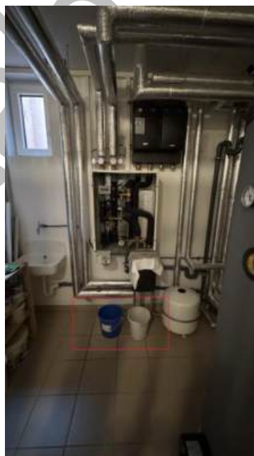
02 Heizungsanlage tropft (am Ortstermin hörbar)
