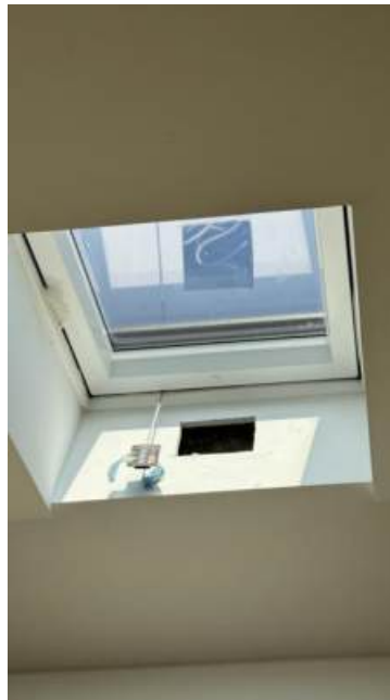
01 Dachflächenfenster im Treppenhauskopf (vermutlich Steuerung lose)
