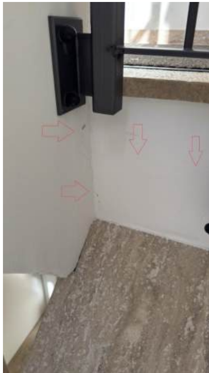
05 diverse Risse im Treppenhaus
