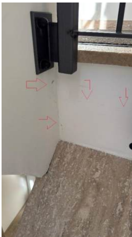
03 diverse Risse im Treppenhaus
