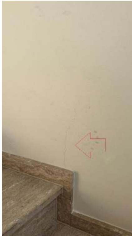
05 diverse Risse im Treppenhaus
