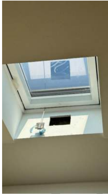
01 Dachflächenfenster im Treppenhauskopf (vermutlich Steuerung lose)
