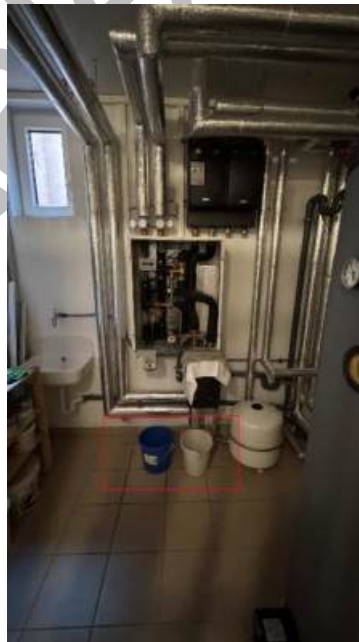
02 Heizungsanlage tropft (am Ortstermin hörbar)
