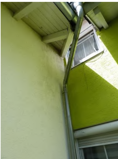
Gebäude 1: Einfamilienhausanbau, Teilansicht Außenwandanschluss an Nachbargebäude mit Wandverfärbungen
