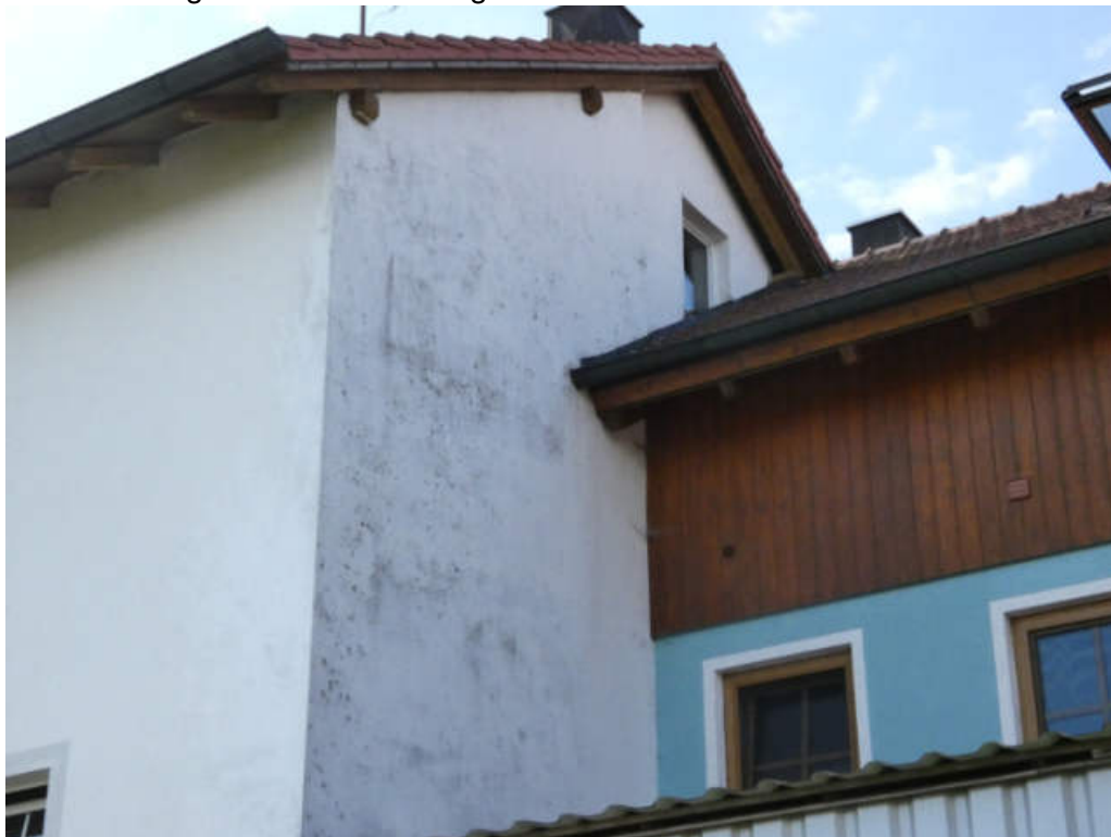
Bild 7: Fleckige Fassade Richtung Nord-West
