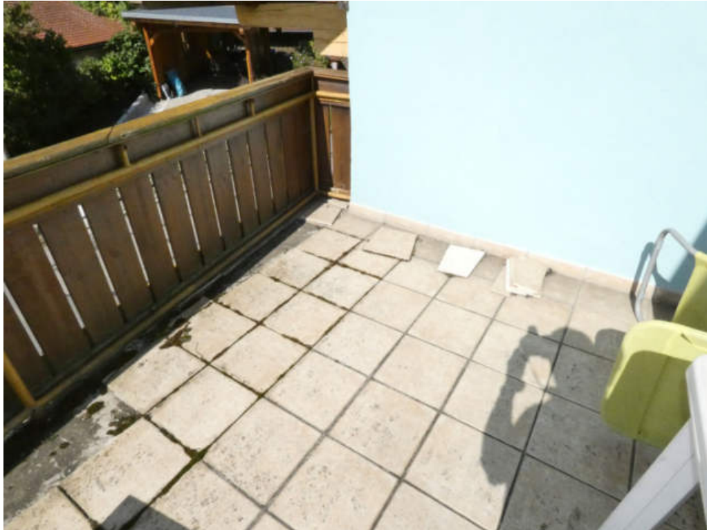
Bild 34: Balkon mit Frostschäden im äußeren Bereich
