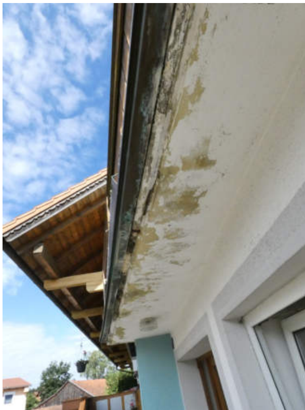
Bild 4: Unterseite Balkon mit Forstschaden
